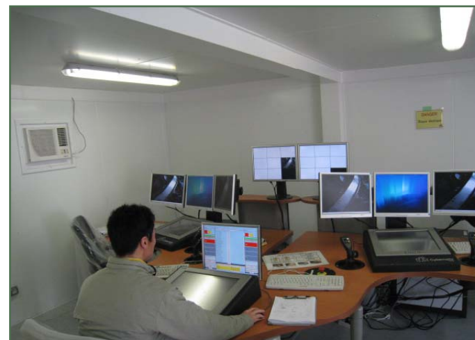
遠隔解体装置操作室
