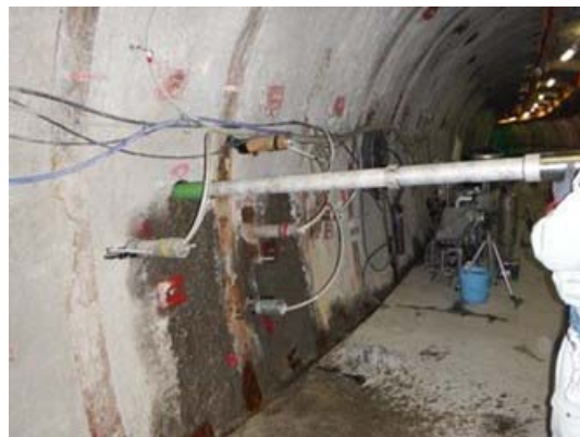
トレーサー試験装置の設置
